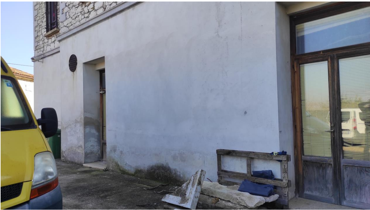
Hier soll eine Überdachung für den Handwerkuntritt gebaut werden.
